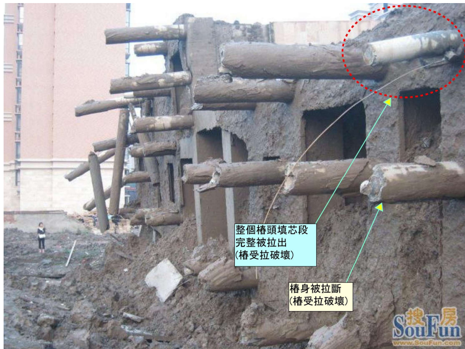
▲图 1-6: 大楼倒塌事件中，PC/PHC 桩受拉力而破坏的情形 [2]
