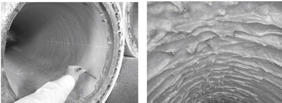
图 3-1 一般管桩桩壁浮沫(左图最内侧白色薄膜状)多未经妥善处理。
