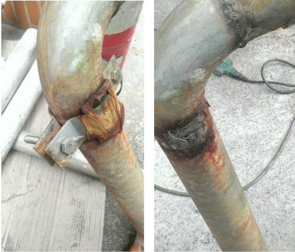
▲圖 1-4：傳統彎頭環口焊縫處較易破裂 [1]
